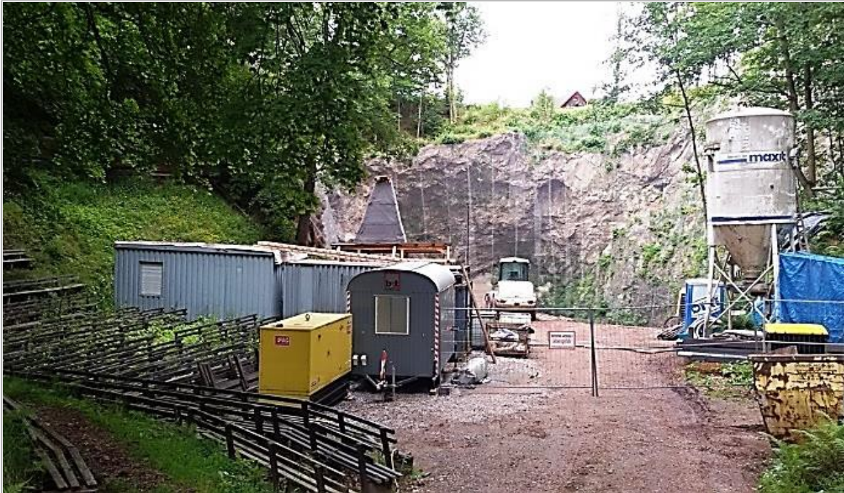
Abbildung 41: Sanierungsarbeiten des Oberbergamtes zur Sicherung der Entwässerung von untertägigen Schächten und Stollen (Foto Berthold Haß)
